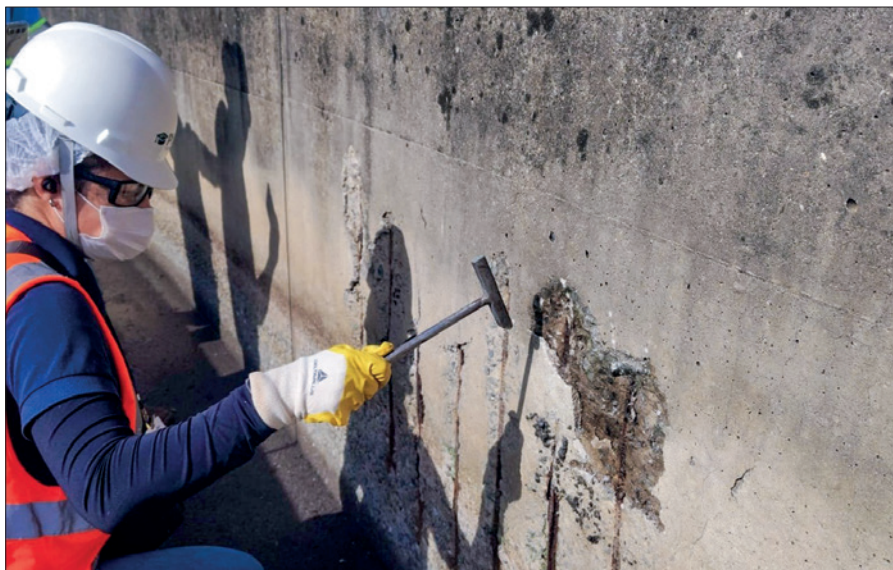
Figura 5 — Rinspeção de obra com problemas de baixo cobrimento e corrosão de armaduras (Acervo dos autores, 2025)
